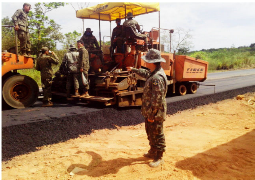
Figura 7.15: soldados lançam asfalto no trecho de obras. Fonte: 1º Tenente R/2 Pinheiro
