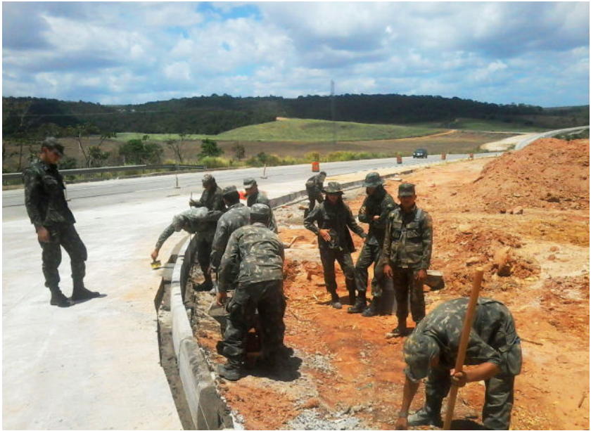
Figura 7.16: soldados lançam meio-fio pré-moldado no trecho de obras. Fonte: 1º Tenente R/2 Pinheiro.
